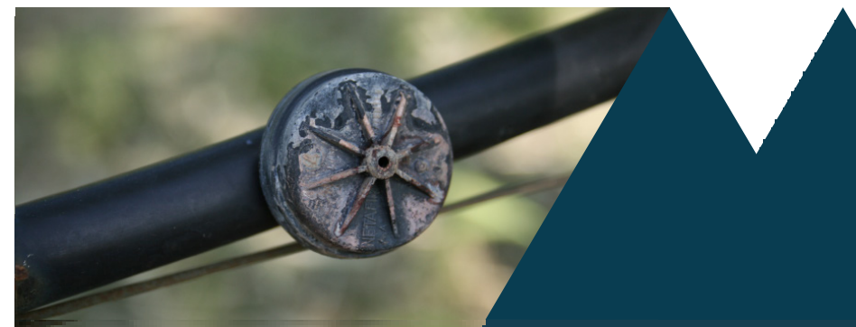
Gotero obstruido a causa de un mal mantenimiento de la instalación (Foto: ECA Tàrrrega).
